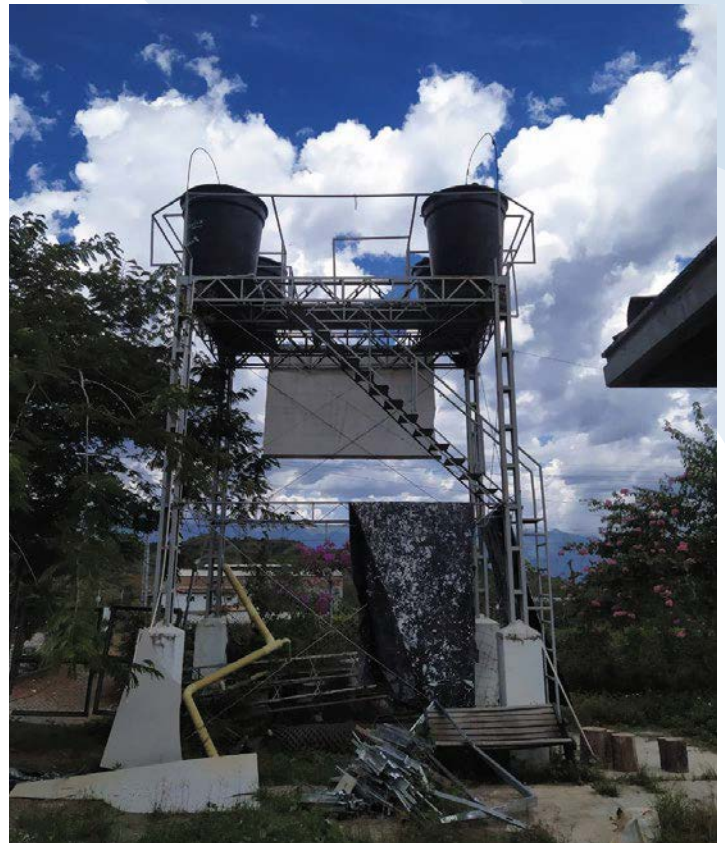
Tanques de agua actual
